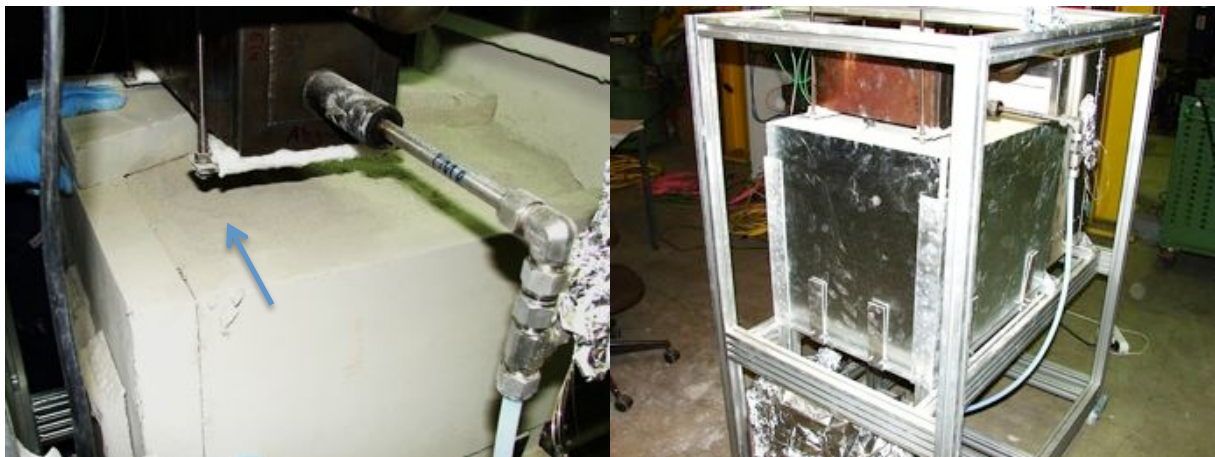
Abbildung 3.5.1-7: Schüttisolierung (links), Blechverkleidung (rechts)
