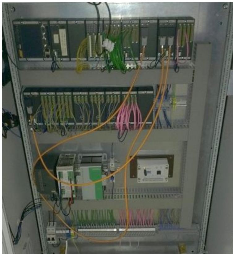
Abbildung 3.5.2-1: Aufbau des Schaltschranks während der Inbetriebnahme
