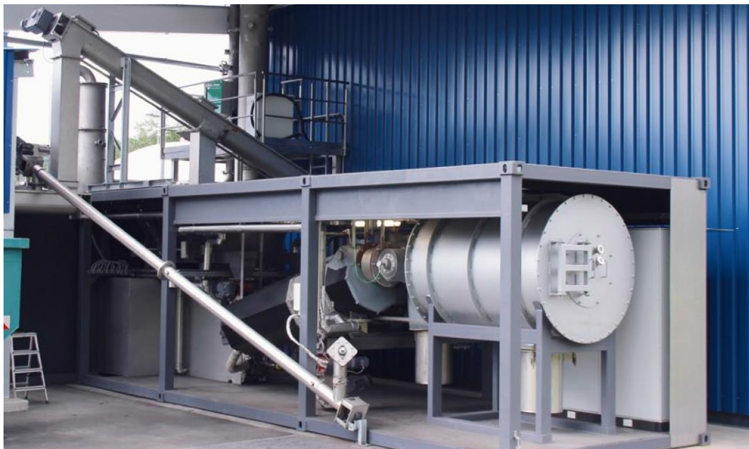
Abbildung 4.13: Foto des Pyreg-Moduls auf der Kläranlage Linz-Unkel [Linz-Unkel 2016]
