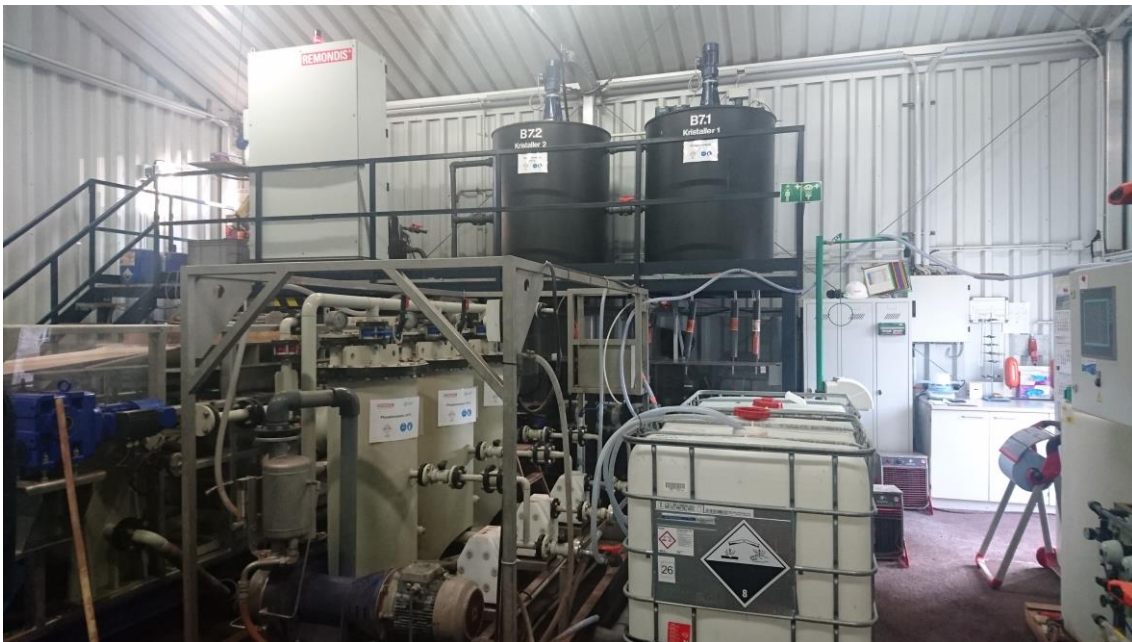
Abbildung 4.7: Foto der Hamburger Pilotanlage [Quelle: CUTEC, mit Genehmigung Remondis]
