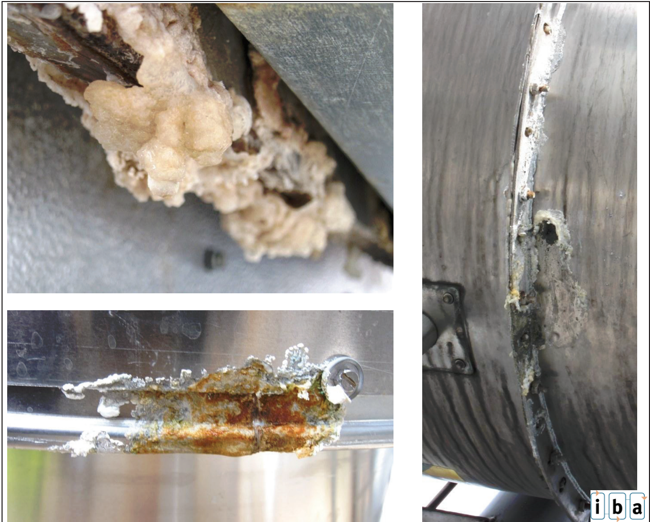
Abb. 2.2-2: Austritt von Ammoniumsulfat an undichten und korrodierten Verbindungsstellen in der Abluffleitung
