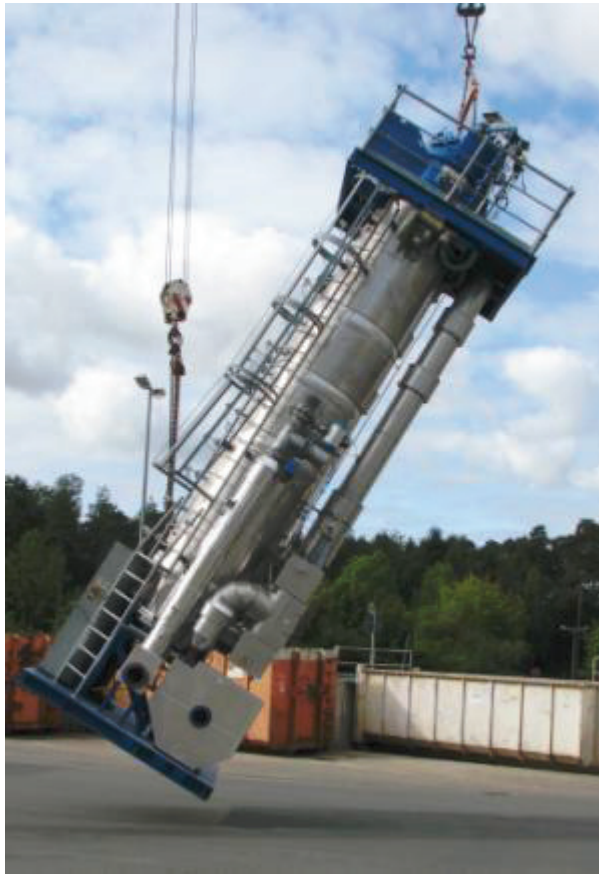
Abb. 6.2-3: Aufstellung der RTO
