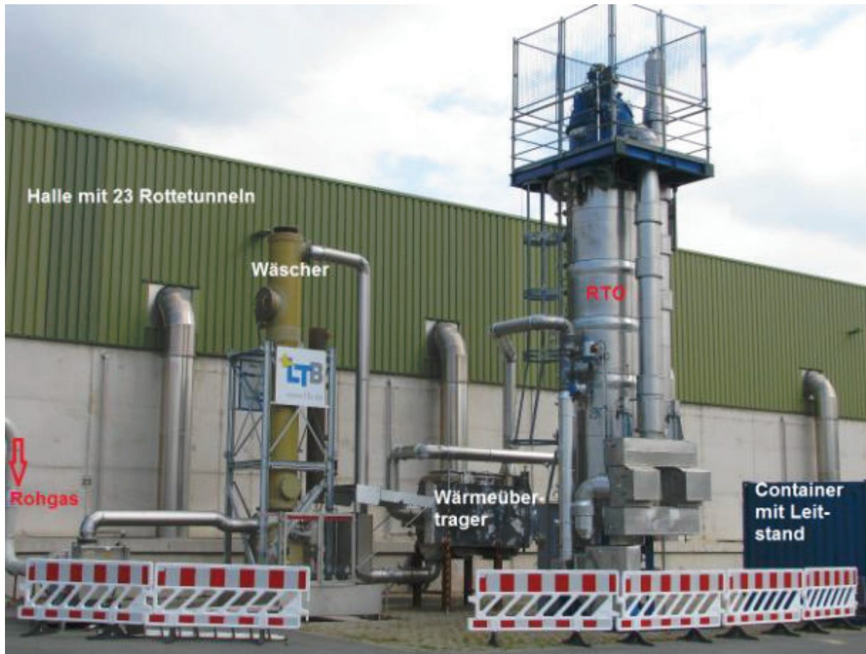
Abb. 6.2-5: Gesamt-Versuchsanlage, bestehend aus Wäscher, Wärmeübertrager und RTO
