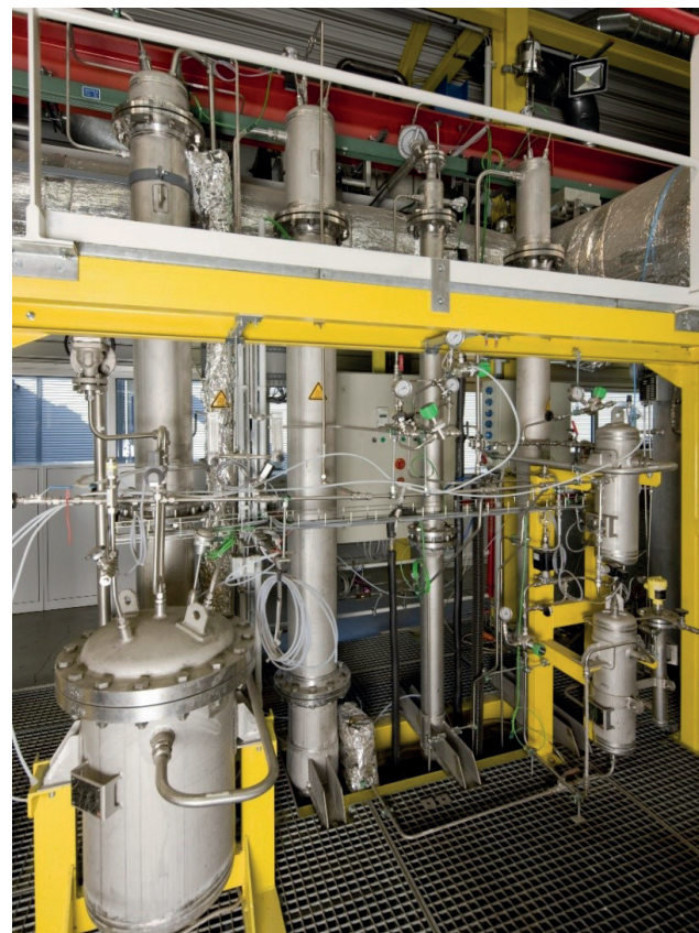
Bild 3: Technikumsanlage zur CO 2 -Absorption und -Desorption (Foto: CUTEC)
